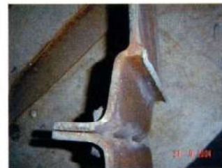
Photo 3 : Rupture de la platine au voisinage du cordon de soudure.
