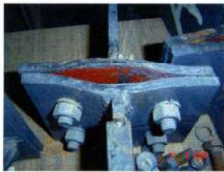
Photo 5 : Deuxième mode de ruine – Mécanisme partiel dans la platine.
