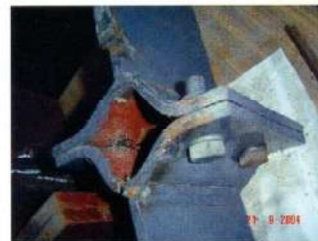
Photo 2 : Premier mode de ruine – Mécanisme complet dans la platine – début de rupture de la platine au voisinage du cordon de soudure.
